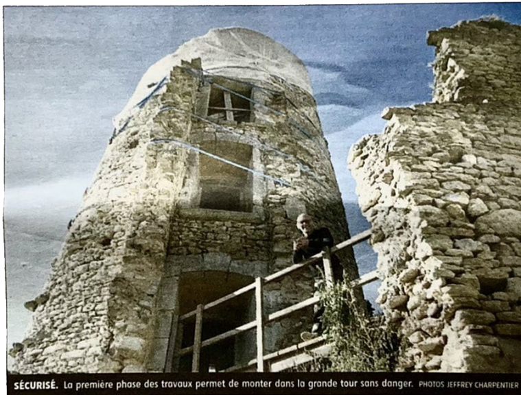
SÉCURISÉ. La première phase des travaux permet de monter dans la grande tour sans danger. PHOTOS JEFFREY CHARPENTIER
